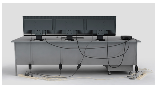
Herkömmliche Lösung: unordentliche Verkabelung
